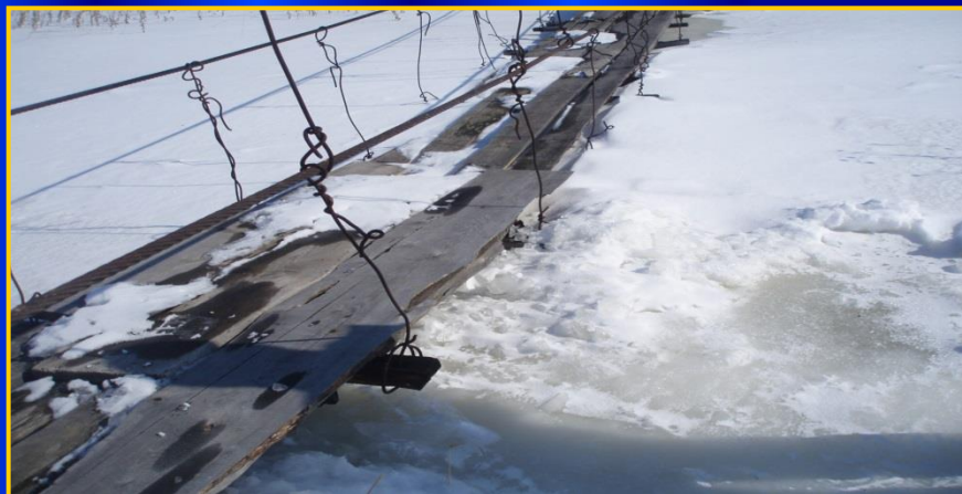
Наледь на реке Бобровка, мост во льду
