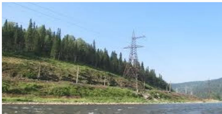
Рис.3 Опоры. ЛЭП, вдоль русла р. Томь. Воплощение труда изыскателей.
